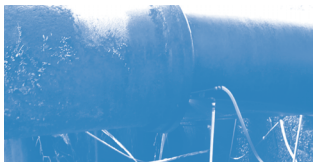
FLAGRANTE DE LIGAÇÕES CLANDESTINAS EM ADUTORA
