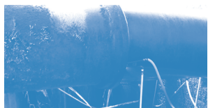
FLAGRANTE DE LIGAÇÕES CLANDESTINAS EM ADUTORA
