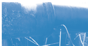
FLAGRANTE DE LIGAÇÕES CLANDESTINAS EM ADUTORA
