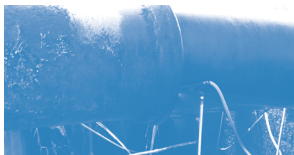
FLAGRANTE DE LIGAÇÕES CLANDESTINAS EM ADUTORA
