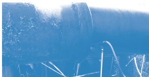
FLAGRANTE DE LIGAÇÕES CLANDESTINAS EM ADUTORA
