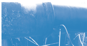
FLAGRANTE DE LIGAÇÕES CLANDESTINAS EM ADUTORA
