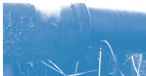
FLAGRANTE DE LIGAÇÕES CLANDESTINAS EM ADUTORA
