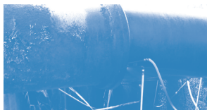
FLAGRANTE DE LIGAÇÕES CLANDESTINAS EM ADUTORA
