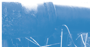
FLAGRANTE DE LIGAÇÕES CLANDESTINAS EM ADUTORA
