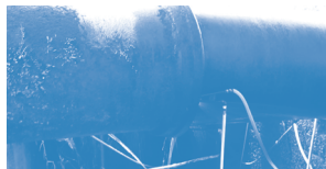
FLAGRANTE DE LIGAÇÕES CLANDESTINAS EM ADUTORA
