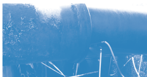
FLAGRANTE DE LIGAÇÕES CLANDESTINAS EM ADUTORA
