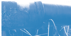
FLAGRANTE DE LIGAÇÕES CLANDESTINAS EM ADUTORA
