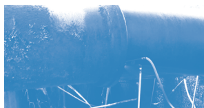
FLAGRANTE DE LIGAÇÕES CLANDESTINAS EM ADUTORA
