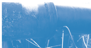
FLAGRANTE DE LIGAÇÕES CLANDESTINAS EM ADUTORA
