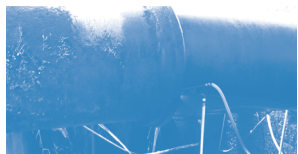
FLAGRANTE DE LIGAÇÕES CLANDESTINAS EM ADUTORA
