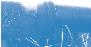
Flagrante de ligações clandestinas em adutora
