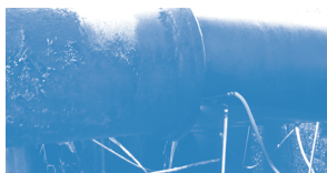
FLAGRANTE DE LIGAÇÕES CLANDESTINAS EM ADUTORA
