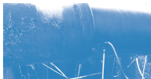
FLAGRANTE DE LIGAÇÕES CLANDESTINAS EM ADUTORA
