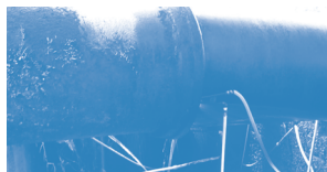
FLAGRANTE DE LIGAÇÕES CLANDESTINAS EM ADUTORA
