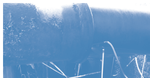
FLAGRANTE DE LIGAÇÕES CLANDESTINAS EM ADUTORA
