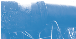
FLAGRANTE DE LIGAÇÕES CLANDESTINAS EM ADUTORA
