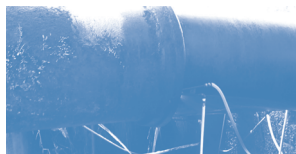
FLAGRANTE DE LIGAÇÕES CLANDESTINAS EM ADUTORA
